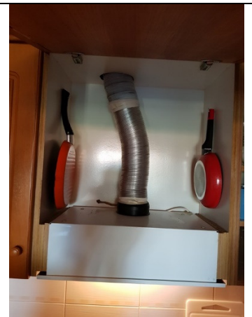
Stekpannor i fläktskapet 2 st
